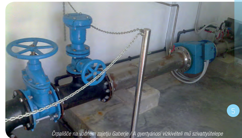
Črpališče na vodnem zajetju Gaberje / A gyertyánosi vízkivételi mű szivattyútelepe
